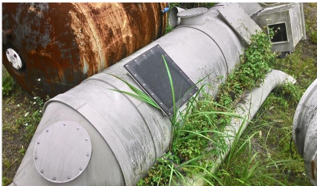
(編號 13、14) 冷棟機共二台
