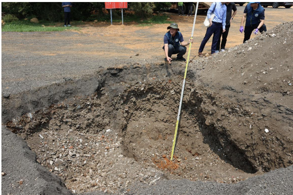
便道回填廢棄物情形
